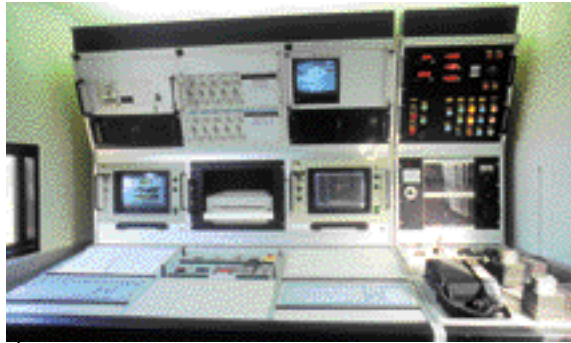
Équipement électronique de la cabine laboratoire
