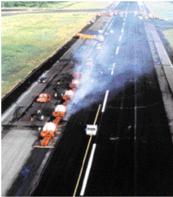
Aéroport de Pointe à Pitre. Thermogénération
