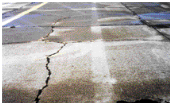
Chaussée avec dalles en béton fracturées
