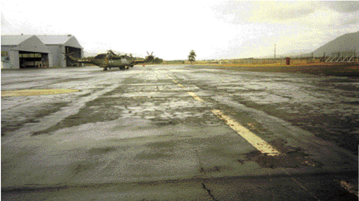
Exemple de chaussée totalement craquelée
